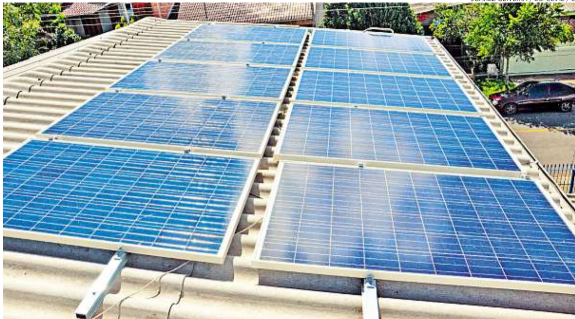
Conexão dos sistemas de geração de energia solar particulares à rede de eletricidade é prioridade de programa do governo federal
